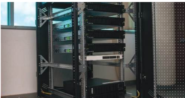
Les infrastructures installées au niveau du MSANP permettent d'héberger les données pour 15.000 utilisateurs à terme, extensibles.
